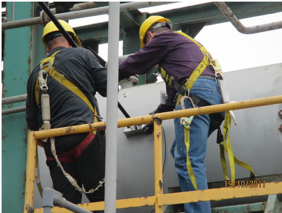
Figura 5. Aplicación en el tanque de regulación de presión.
